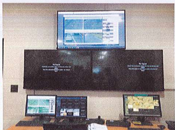
ห้องควบคุม Server Room ๑๙๑
